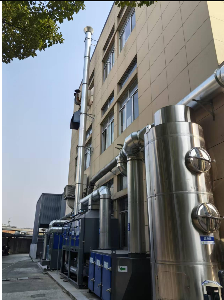
水喷淋+干式过滤器+活性炭吸附+脱附+催化燃烧处理装置和排气筒 根据废气处理设施设计安装单位提供资料，废气处理设施相关参数见下表。
