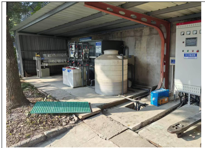
废水处理设施
